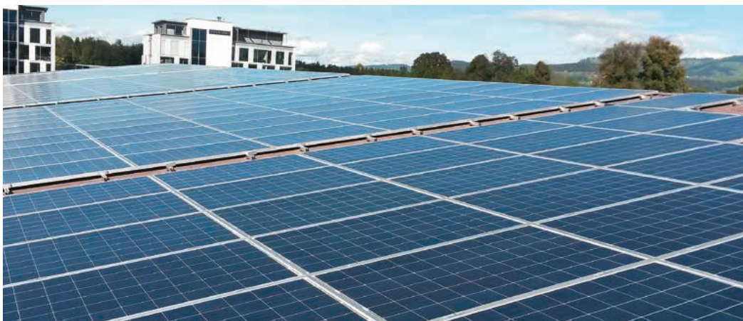
Teilansicht Werkhofdach mit Solarmodulen
